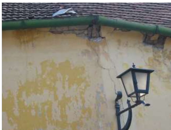
Repedés és beázás okozta károsodás
